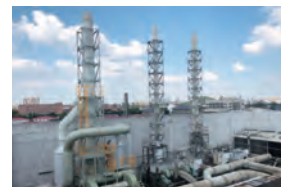
D2棟 VOC水洗装置
