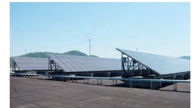
太陽光パネル
