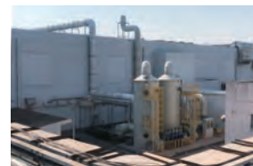
D1棟 VOC水洗装置
