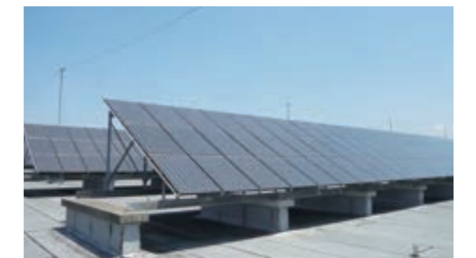
太陽光パネル
