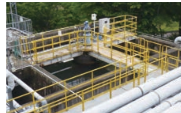
排水処理設備
