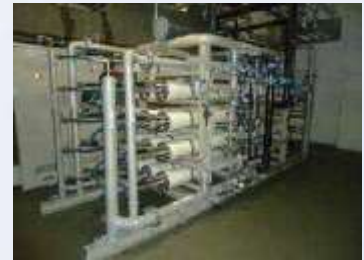
濃縮水回収処理装置
