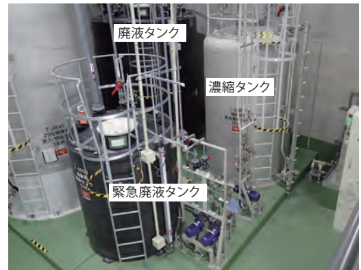
供給タンク、廃液タンク外観
