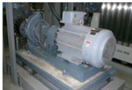
冷却水ポンプ外観
