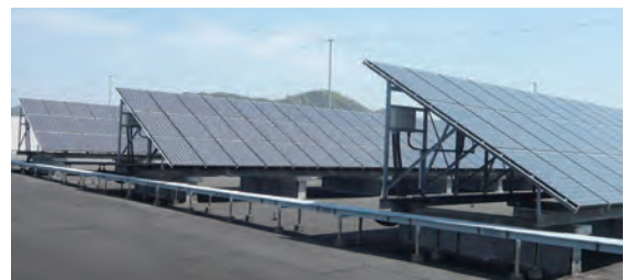
鳥取工場の太陽光発電パネル
