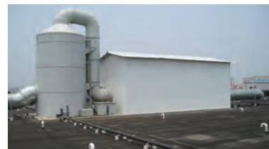
VOC 除害設備
