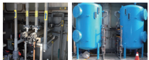
生産プロセスの廃水回収再利用設備
