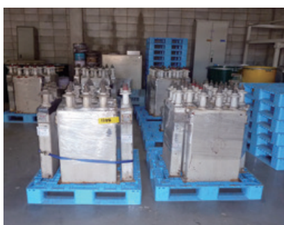
大型高濃度PCB廃棄物(コンデンサ)
