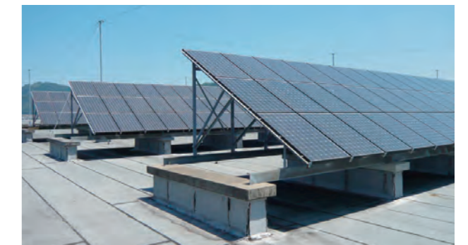
太陽光パネル
